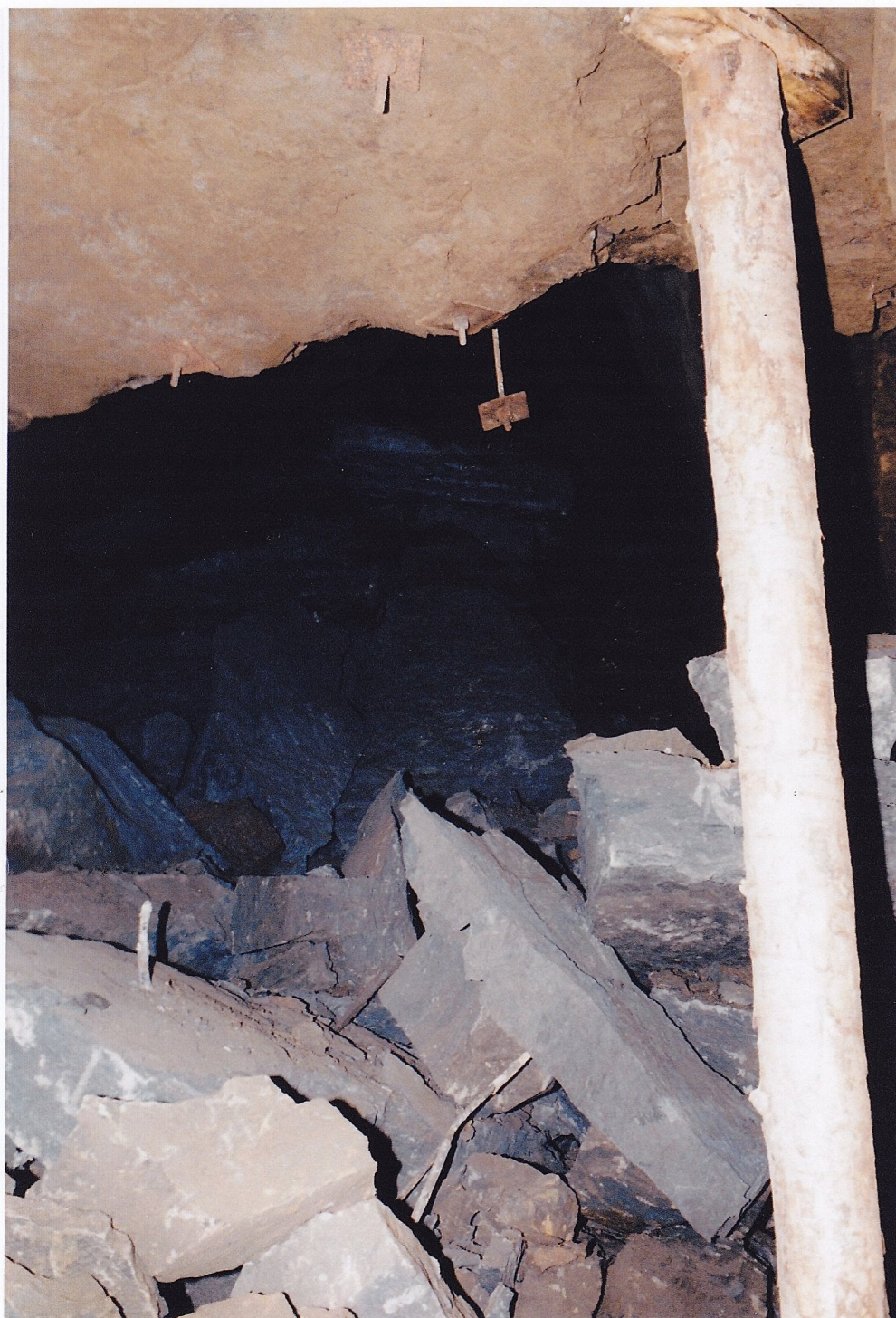
Mine Orne-Roncourt-Paradis. L'éboulement en limite de dépilage 17 septembre 1992
